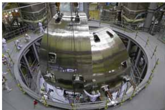
図1：組立て中のJT-60SA。2つ目の真空容器セクターを設置しているところ。
