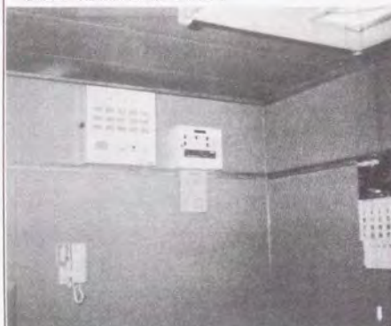
宿直室、緊急通報装置
