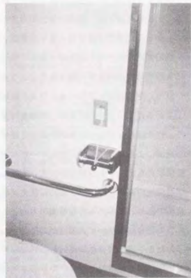
便所内通報ボタン
