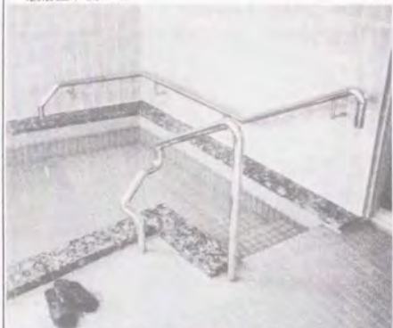
一般浴室（軽度障害用）手摺あり
