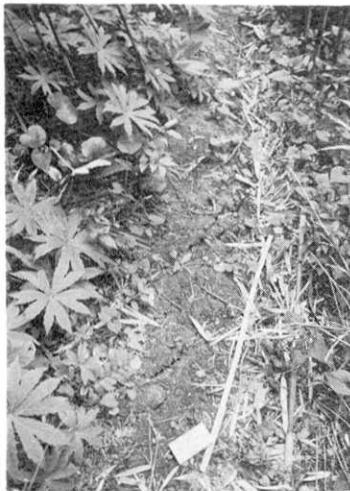
Fig. 10. En echelon cracks at Loc. 2.
