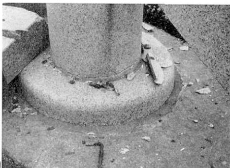
Fig. 5 山形県鼠ヶ関厳島神社の鳥居の花崗岩から作られた円い柱の根元の割目，柱が曲げ，ねじり破壊を受けたと思われる。
