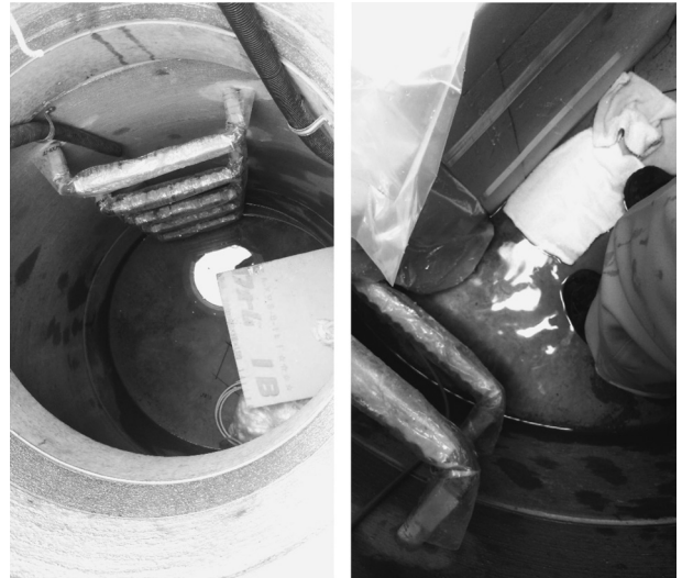
図 18. 地震計台内への浸水
