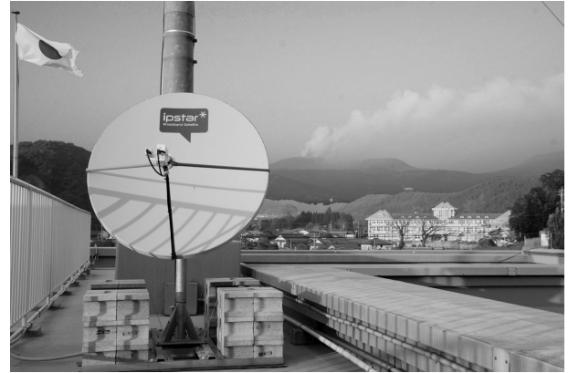
図 4. 霧島総合支所の屋上に設置された衛星通信回線用パラボラアンテナ。奥には新燃岳が見える。
