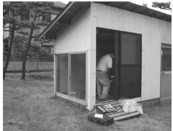
図 31. 柏崎市立荒浜小学校物置での地震計設置状況
