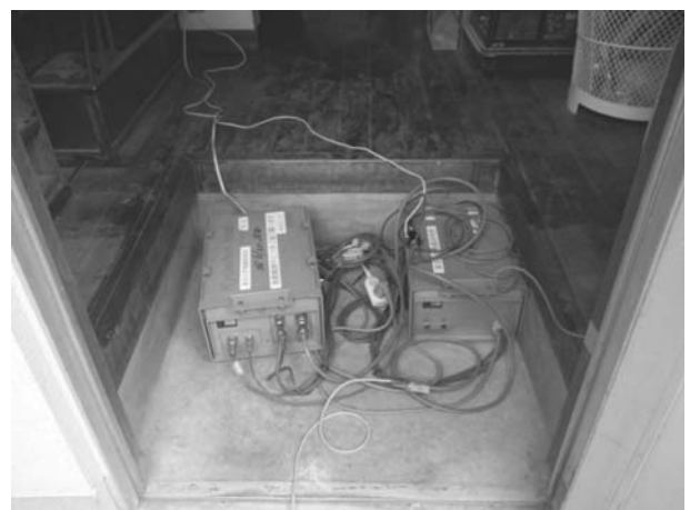
図 21. K-net95 型強震計の設置状況 (臨時観測点)
