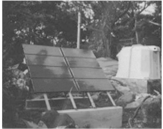
図16. 手石島総合観測施設の全景（太陽パネルと局舎）
