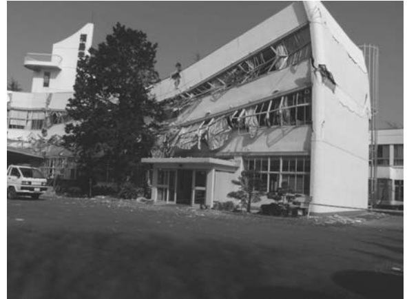
図 35. 2階3階部の崩壊状況(福島学院大学本部棟)
