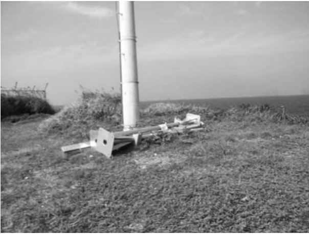
図 14. 高台上げられた太陽電池モジュール支柱と他資材
