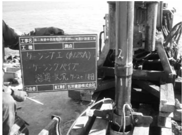
図 23. 地震計埋設用ケーシング管溶接と外側 8 インチ鋼管ケーシング管の罫書き線 N 方向に向け抽出
