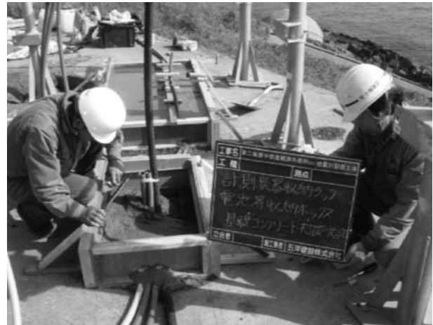
図 30. 手前: 観測装置取付け台, 後方: バッテリー取付け台
