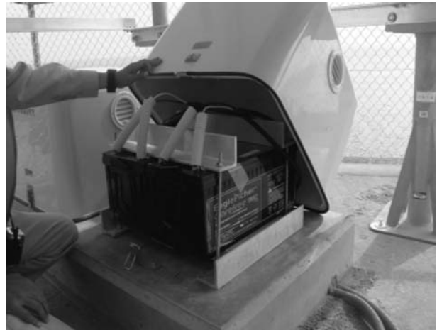
図 36. バッテリーの取付け状況と保護カバー（FRP）
