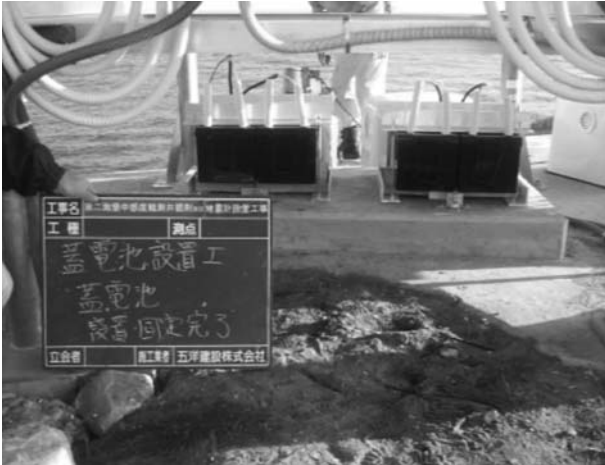
図 35. 塩害防止のため台から離れたバッテリーの取付け
