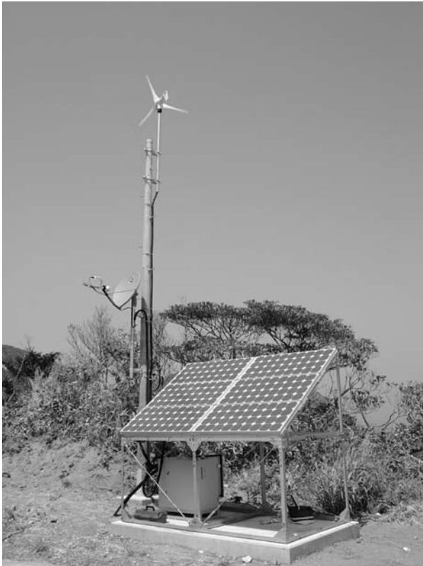
図 6. 神津島観測点のSAO サービス VSAT とハイブリッド独立電源装置の全景。地震研究所における最初のSAO サービス利用観測点である。
