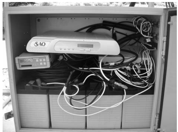
図 5. 金属箱内の機器収容状況。上に載っているのが SAO の IDU。その下は LS-7000XT (左) と電源コントローラー (右)。下は 4 個の鉛蓄電池。
