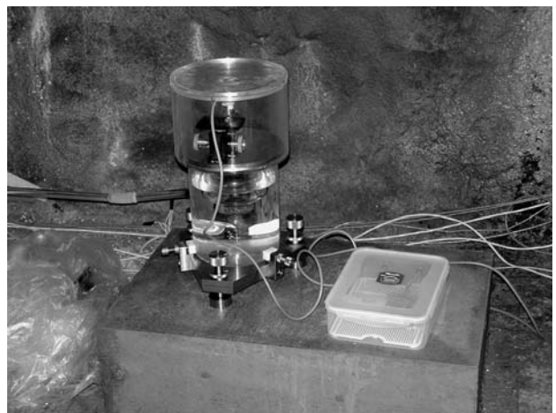
図 26. 設置が完了した水管傾斜計
