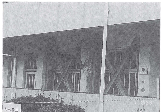
図 34. 2棟北構面補強部分、3月26日の地震でこの柱のみ破壊した。その後鉄骨ブレースにより補強されていた。
