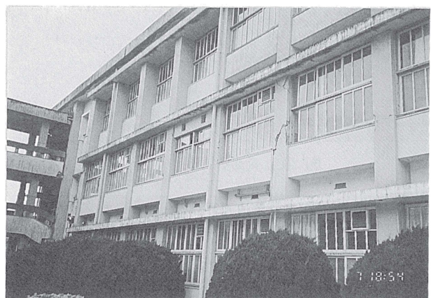
図 35. 2棟南構面、1階の補強により2階の柱に被害が集中
