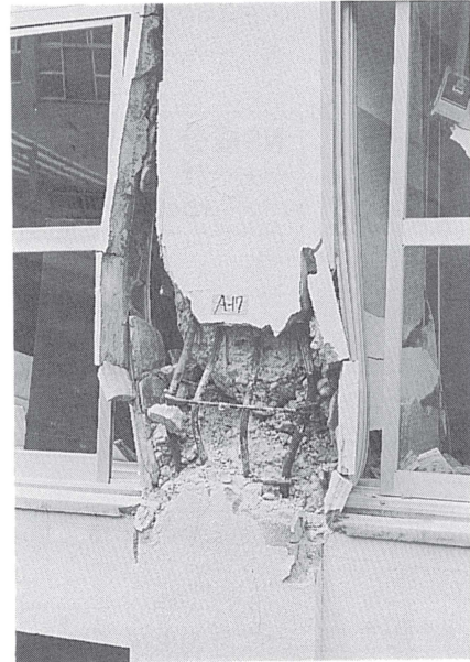
図 19. 北棟北構面柱の破壊状況
