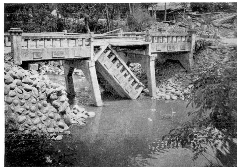
第 202 圖 内 埔 庄 屯 子 脚 に 於 け る コ ン ク リ ー ト 橋 の 被 害 (5 月 2 日 撮 影, 高 橋) Fig. 202. Concrete girder bridge, Tonsikyaku, Naiho-syô.
