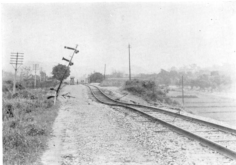
第139圖 三又驛北方軌道の沈下.
