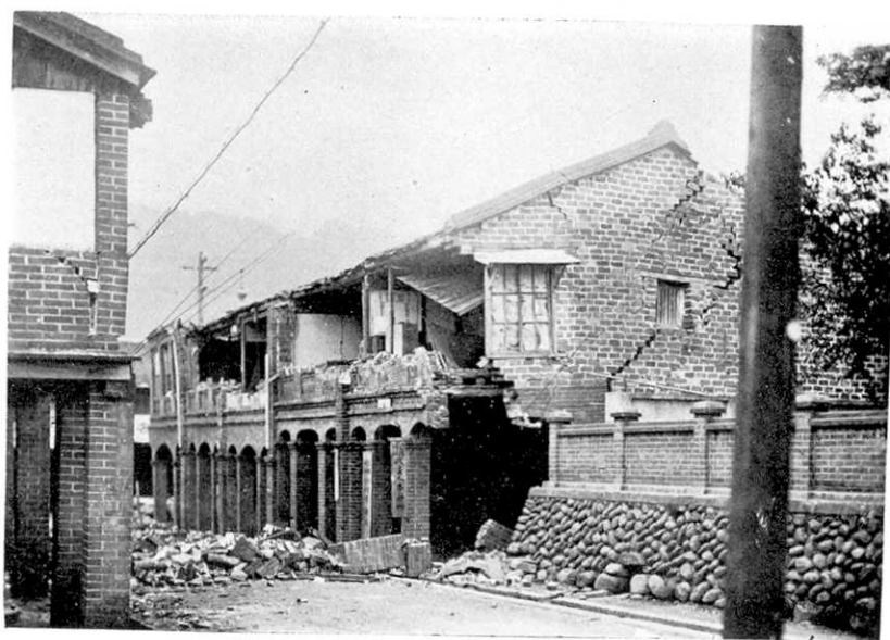
第132圖 大湖庄大湖. 主要街の煉瓦造家屋の被害.
