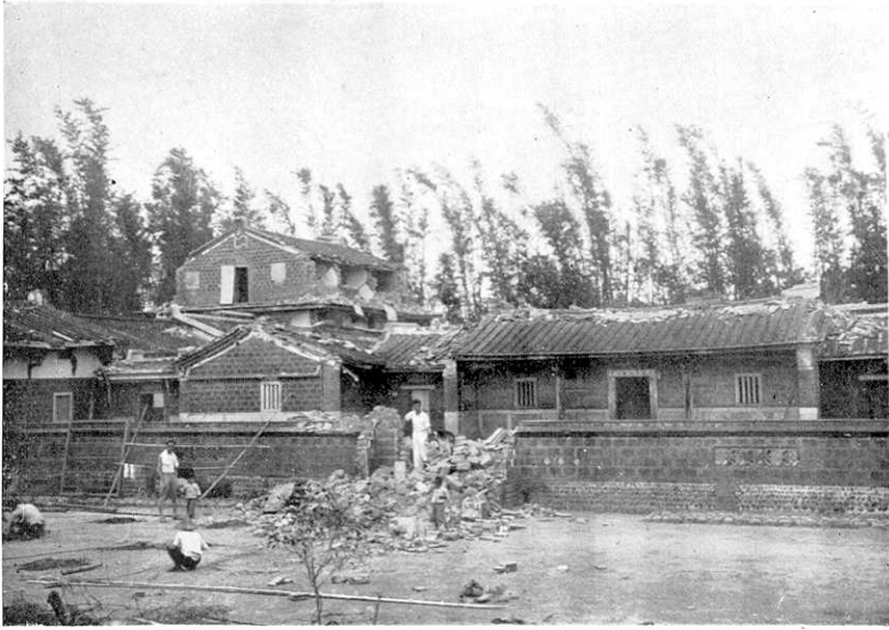
神 236 圖 神岡庄. 北庄に於ける良構造の土塙家屋の損傷. Fig. 236. Hokusyô, Kamioka-syô. Damage to a dokaku house of good construction.
