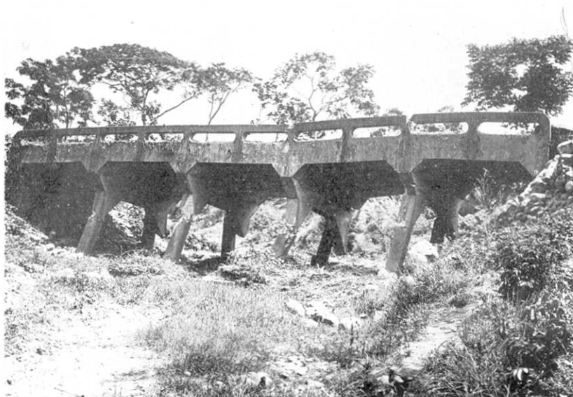
第181圖 后里驛西方約1km, コンクリート橋の破損.
