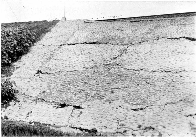
第 240 圖 甲南清水間築堤法面の亀裂.
