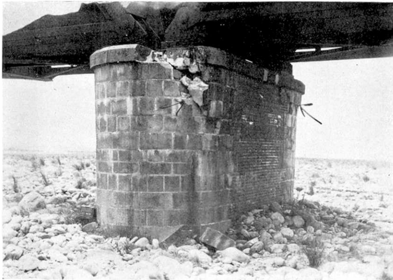
第162圖 大安溪鐵橋々脚の被害.
