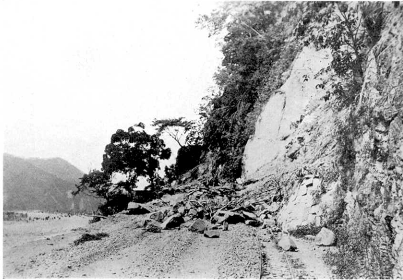
第 117 圖 公館庄福基出礦坑間の崖崩れ。 Fig. 117. The rockfall near Hukki, Kōkan-syō.
