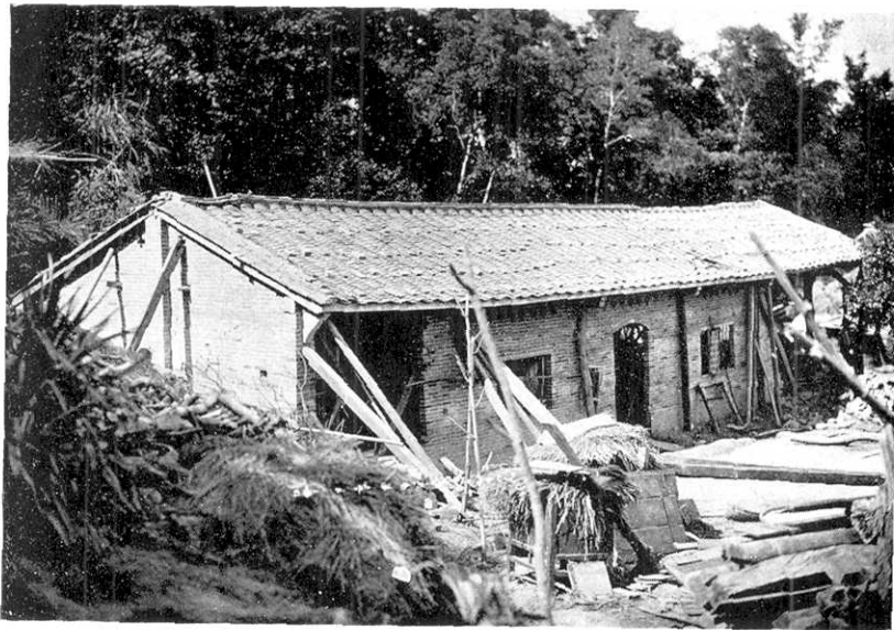
第 32 圖 三灣庄三灣. Fig. 32. Damage of brick house at Sanwan, Sanwan-syô.
