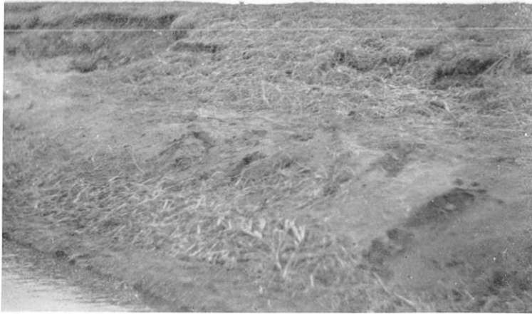
第 408 圖 宮城縣荒濱村附近に於ける阿武隈川河岸の堤防。一部崩れて砂其他の漂流物沈著せり。(3 月 28 日宮部撮影)
