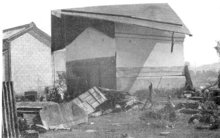
第 278 圖 釜石町場所前。場所前の主道路の海に近い方側にある土蔵、漂流物の激突により屋根廻轉せり。土蔵の四角は船等の衝突の爲に破損せり。鯖柏の油及火事の灰により土蔵の白壁に明瞭に津浪の跡つく。(矢印) (3月7日高橋撮影)
