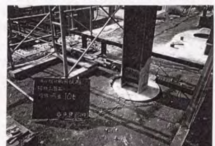
写真-3.1.8 粘性土盛土のクラック状況
