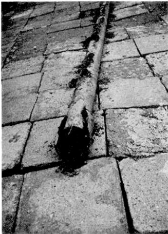
写真 9. 水道管の継手の破壊
