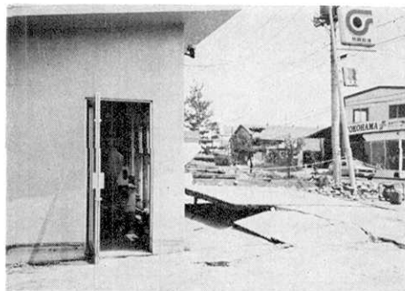
写真13. 河戸川地区のガソリンスタンドの被害
