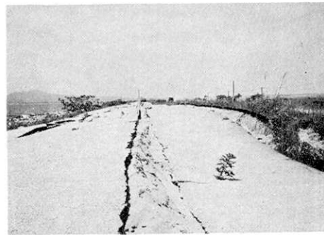
写真19. 平らになった堤防
