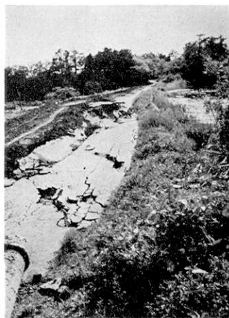
写真14. 木造町のアースフィエルダムの被害
