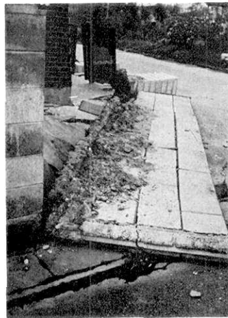
写真17. 液状化により倒れたブロックべい
