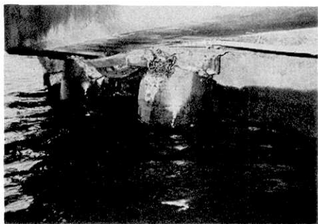
写真 1. 羽黒橋の被害（青森県道路維持課による）
