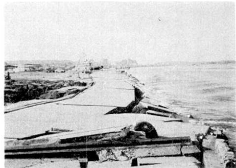
写真 6. 秋田港の護岸の被害
