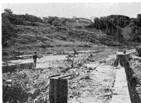
写真23. 秋田県八森町岩館の転倒した防波堤
