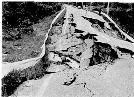
写真 2. 今別—蟹田線の盛土部の陥没の被害（青森県道路維持課による）
