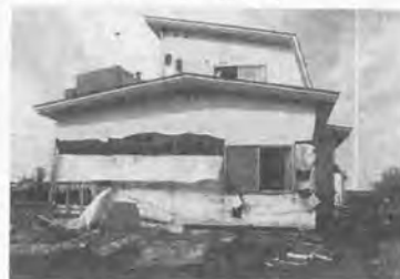
(b) ダンマツ工法で、結露によって土台・隅柱が腐朽し、東方沖地震[1994]で損傷を受けた住宅
