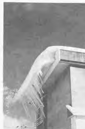
写真 8.6 M型無落雪屋根の障害例
