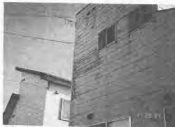
(a) 内部結露水が壁内から外側に漏れ、乾式外装材の汚損が生じている住宅
