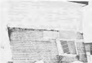
(a) 結露によって腐蝕が腐朽し、釧路沖地震[1993]で損傷を受けた住宅
