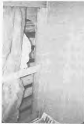
(b) ダンマツを外側に施工した壁で柱と断熱材が湿潤状態にある
