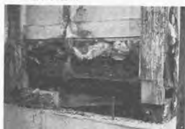
(b) 外装材の張替え時に発見された壁体下部結露による土台・柱下部の腐朽
