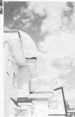
写真 8.11 フラット屋根軒先の巻垂れの発生
