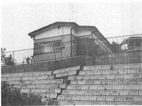
図-46 仙台市緑ヶ丘での盛土部の段差
