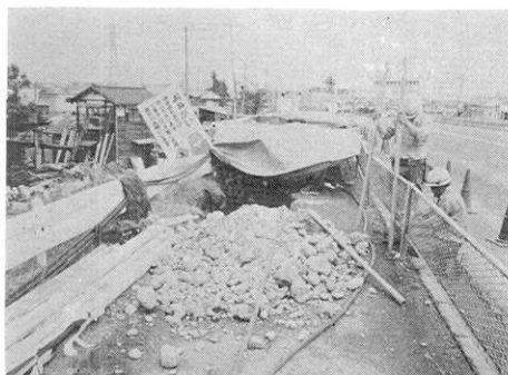
図-34 千代大橋際での通信ケーブルの断線
