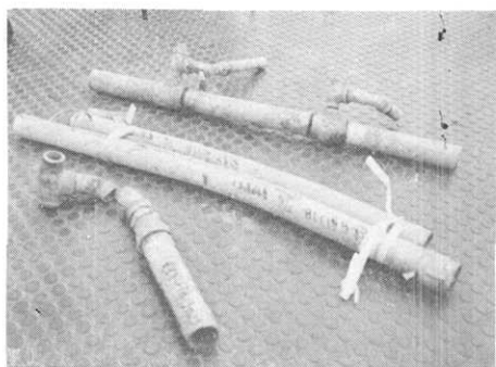
図-33 ガス管の曲がりおよび損壊
