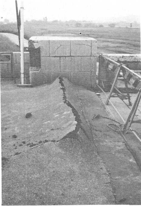
図-9 錦桜橋の舗装面の隆起
