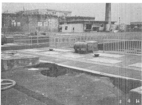
図-29 南蒲下水道処理場における沈殿池横の陥没
