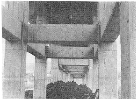
図-17 東北新幹線（建設中）の中間桁のクラック
