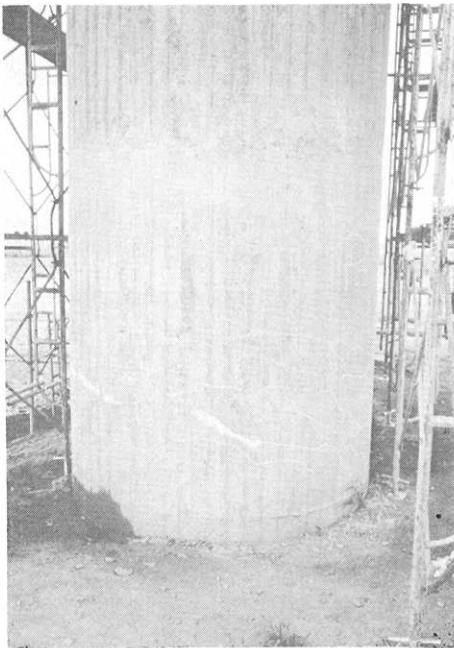
図-10 閑上大橋の橋脚のクラック
