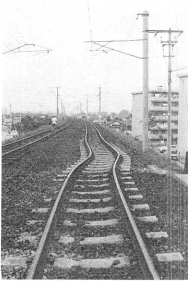
図-14 行人塚高架橋すぐ上の線路の軌道狂い
