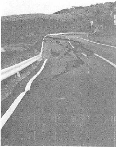
図-3 牡鹿コバルトラインにおける盛土部の崩壊
