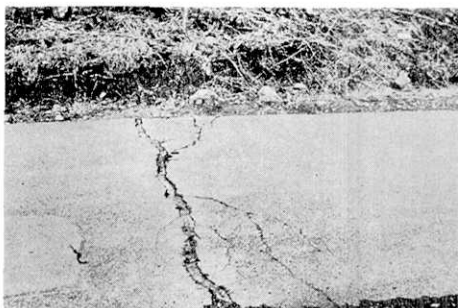
第63図. 稲取ゴルフ場クラブハウス付近の道路の きれつ (Loc. 31).
