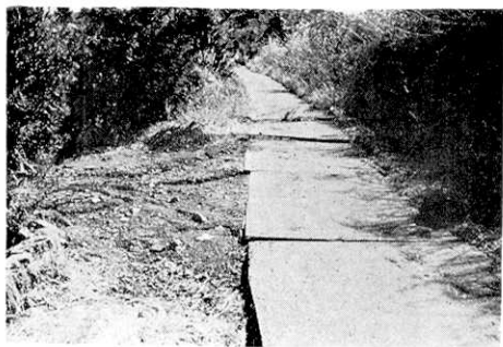
第9図. コンクリート舗装道路の右ずれ, 大峰山東麓 (Loc. 3).
