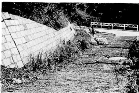
第72図. 稲取トモロ岬北方, 未舗装道路上の地割れ (Loc. 40).
