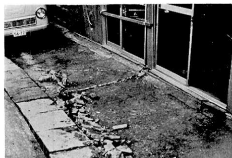
第37図. 稲取水下, 道路側溝と家屋の破損, 田村石男氏宅 (Loc. 21c).
