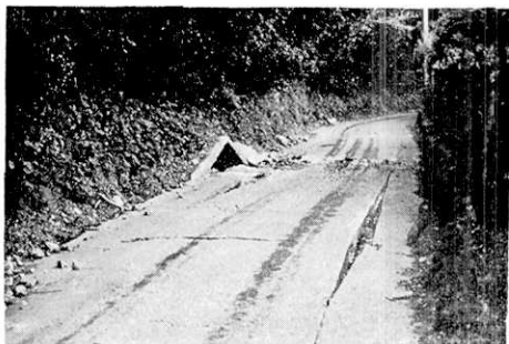
第24図. 稲取入谷, 道路の破壊 (Loc. 15).
