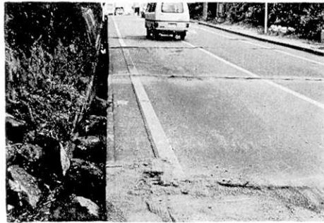
第42図. 稲取水下, 国道を切る右ずれきれつ (Loc. 21b).
