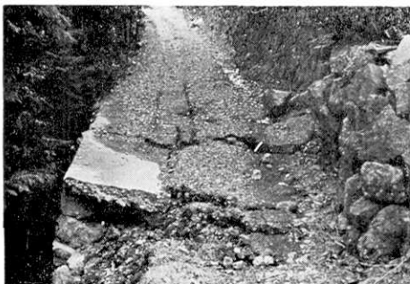
第10図. 道路と石垣の破壊, 切断, 大峰山東麓 (Loc. 6).
