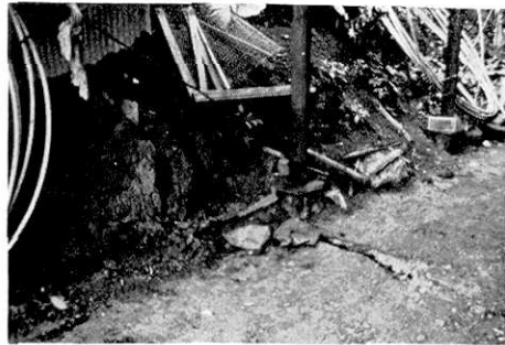
第61図. 根木の田, 切取り土壁とコンクリート土間を切る地割れ, 山本金作氏宅裏.
