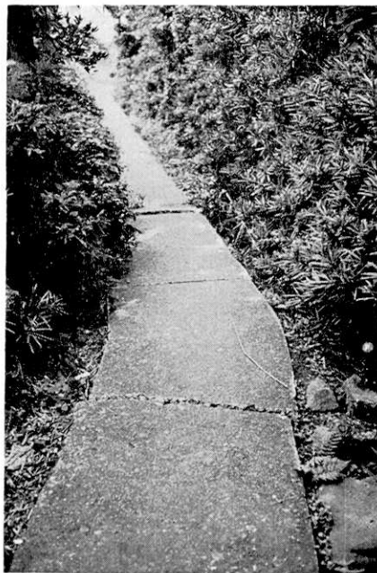
第32図. 稲取入谷, コンクリート舗装道路の破損 (Loc. 19b).
