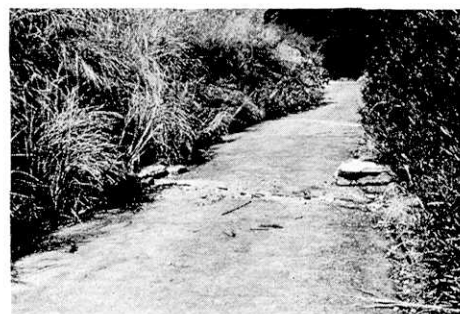
第8図. コンクリート舗装道路の破壊, 大峰山東麓 (Loc. 2b).
