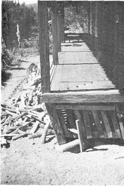
Fig. 14. 床下部分の被害 (柳水流)
