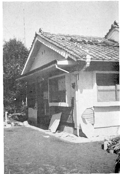
Fig. 21. モルタル壁のはく落 (鶴丸・原口)
