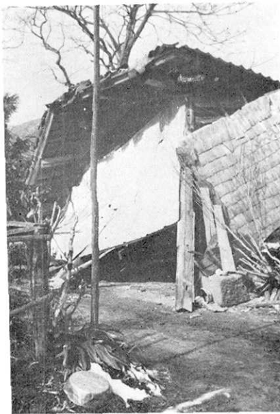
Fig. 20. 木造物置の倒壊 (亀沢)
