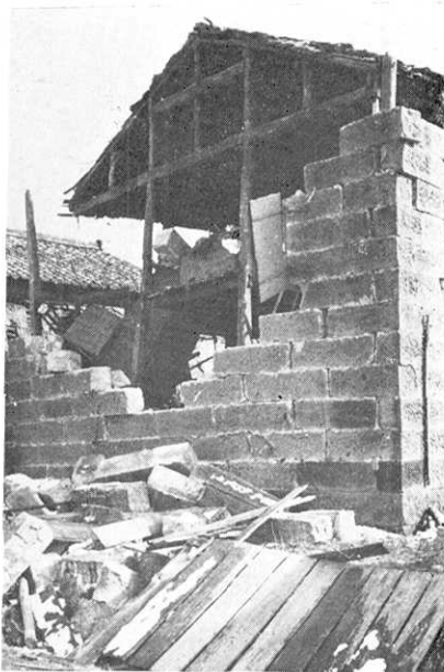
Fig. 10. 大破した土蔵 (京町)
