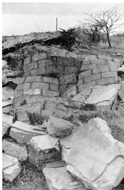
第 37 図 サイロの倒壊。(鷓川)
