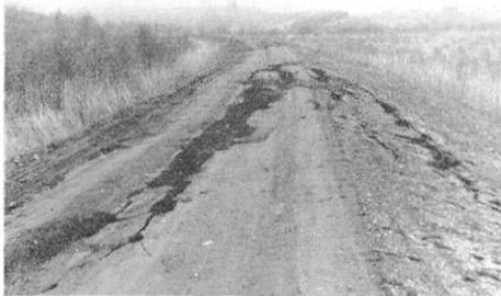
第 48 図 十勝川堤防の亀裂。約 2 km 続 く。(豊頃)
