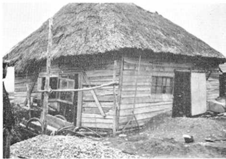
第 12 図 本震で小傾斜、夕方の余震で倒壊寸前になる。(三石)： 三石役場提供
