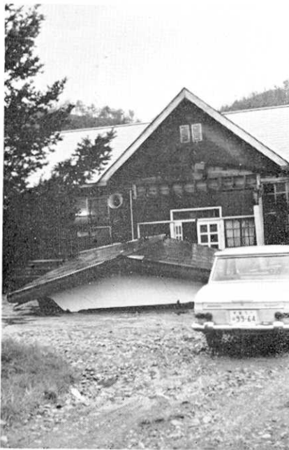
第 14 図 東静内中学校玄関の落下、 (静内)
