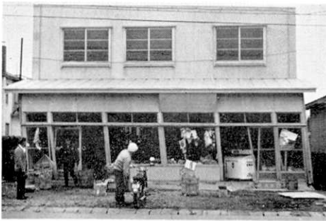
第 18 図 商店の一階が大きく傾斜. ガラスは全部破損. (様似): 様似役場提供
