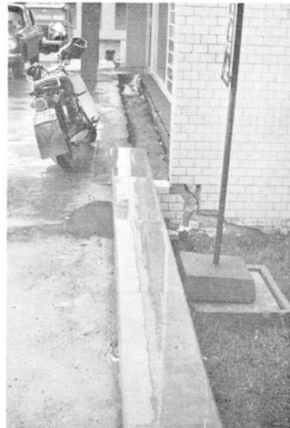
第二十七図 基礎部分の亀裂。(浦河)
