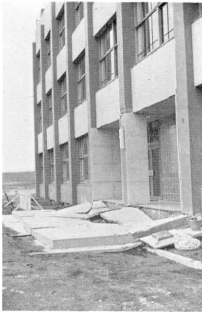
第二十二図 地盤沈下で破損した清水小学校の支関。(苫小牧)
