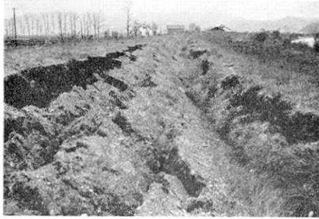
第 46 図 築港道路の欠陥。(三石): 三石役場提供
