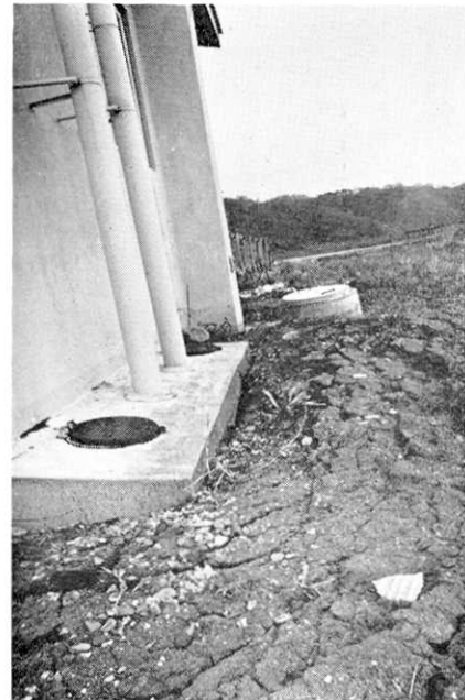
第二十五図 地割れによるブロック建物の沈下。(静内)
