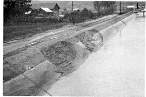
第 47 図 灌漑用水堤防の破損。(中富良野)
