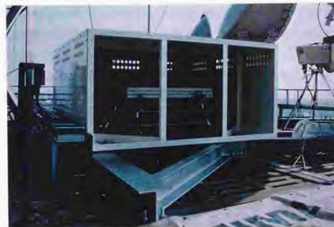
図 5-42 電波塔に設置されたマスダンパの例
