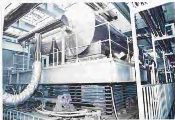
図 5-28 制振装置（設置後）
