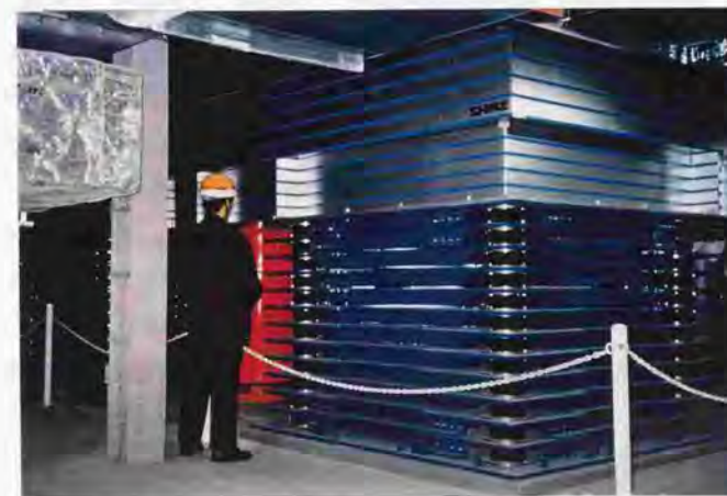
図 5-43 高層建物に設置されたマスダンパの例
