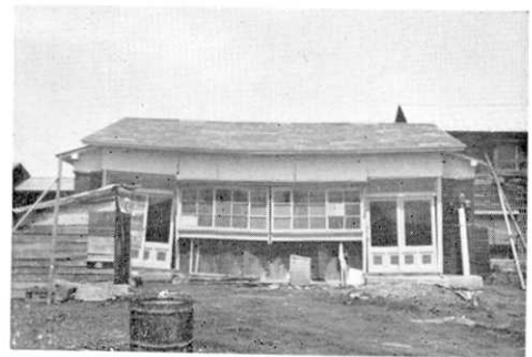
Fig. 13. 基礎の不同沈下で破損した木造住宅 (十和田市)
