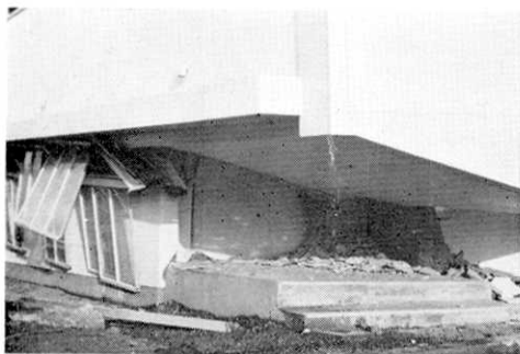
Fig. 34. Fig. 33 の建物の被害詳細 (1)
