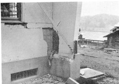
Fig. 44. 鉄骨造体育館のブレースの接合部被害 (豊間内小・中学校)
