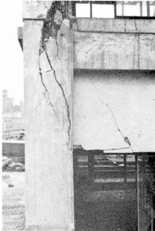
Fig. 30. 壁つき鉄筋コンクリート柱の被害 (八戸市庁舎)
