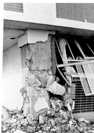
Fig. 35. Fig. 33 の建物の被害詳細 (2)
