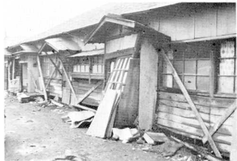
Fig. 5. 低湿地にあつて大傾斜した木造住家 (八戸市中心部)
