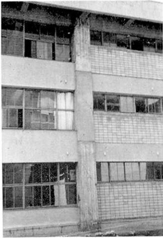
Fig. 40. 腰壁つき柱のせん断ひびわれ (野辺地高校)
