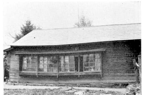
Fig. 19. 基礎が水平にずれて破壊した木造住家 (七戸町)
