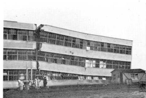
Fig. 33. 鉄筋コンクリート造校舎の増築部分の被害 (三沢商高)
