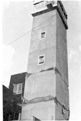
Fig. 41. 鉄筋コンクリート塔の被害 (野辺地消防署望楼)
