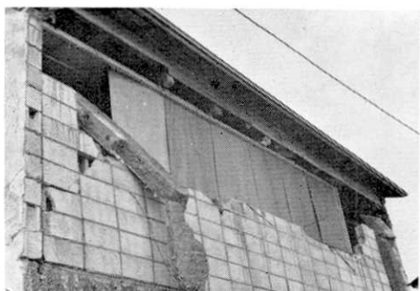
Fig. 46. コンクリートブロック造の被害 (2) (十和田市)
