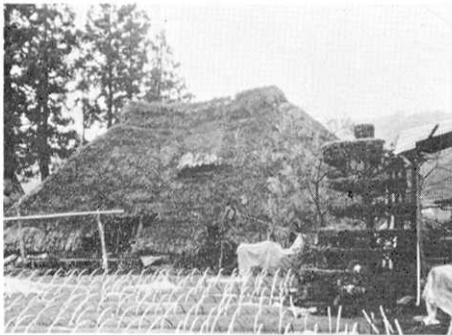
Fig. 6. 完全に倒壊したかやぶきの木造住家 (八戸市滝谷)
