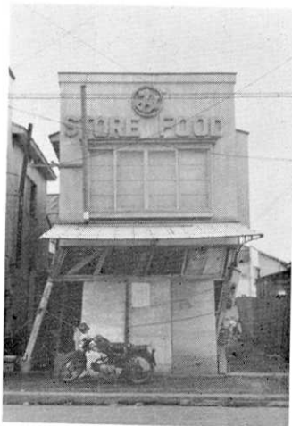
Fig. 14. 1階が大傾斜した木造 2階建店舗 (十和田市)
