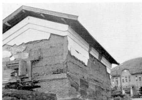
Fig. 49. 土蔵の被害 (むつ市)
