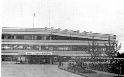
Fig. 38. 鉄筋コンクリート造建築物の一部圧壊 (むつ市役所)
