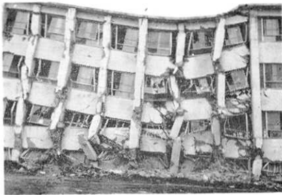
Fig. 42. 1階のつぶれた鉄筋コンクリート造校舎 (函館大学)
