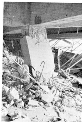
Fig. 39. 鉄筋コンクリート柱の圧壊 (むつ市役所)
