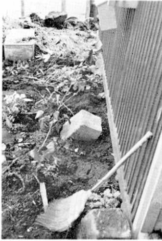
Fig. 16. Fig. 15 の建物の基礎附近
