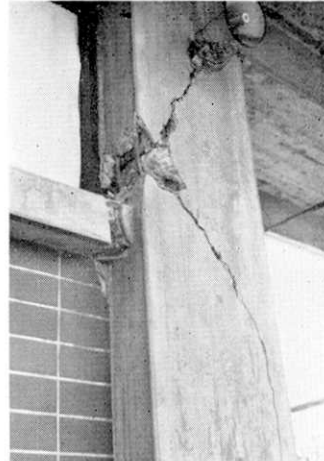
Fig. 31. 腰壁つき鉄筋コンクリート柱のせん断破壊 (八戸市庁舎)
