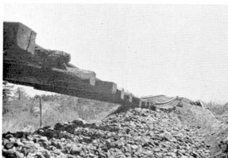
Fig. 51. 鉄道線路の地すべりによる被害 (大湊線)
