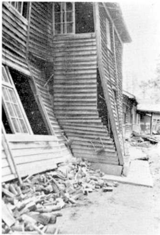
Fig. 4. がけ崩れのため大破した木造小学校 (岩手県浄法寺町)
