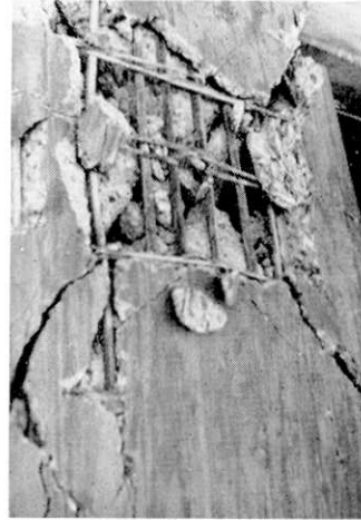
Fig. 29. 鉄筋コンクリート柱のせん断破壊 (八戸市庁舎)
