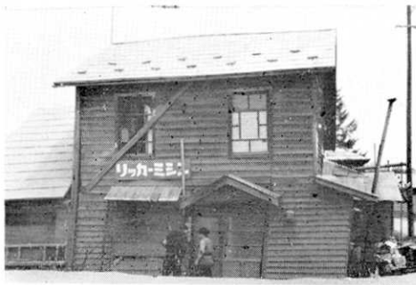
Fig. 18. 1階が大傾斜した木造住家 (七戸町)
