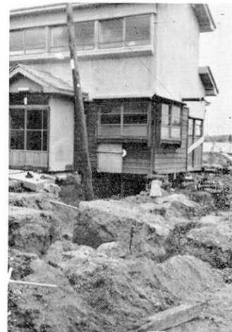
Fig. 21. 地すべりのため破壊した木造住家 (東北町)
