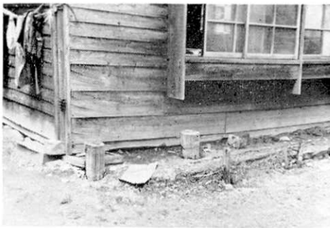
Fig. 20. Fig. 19 の建物の基礎附近
