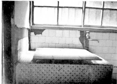
第 18 図 タイル張りの被害 (大月町柏島)
