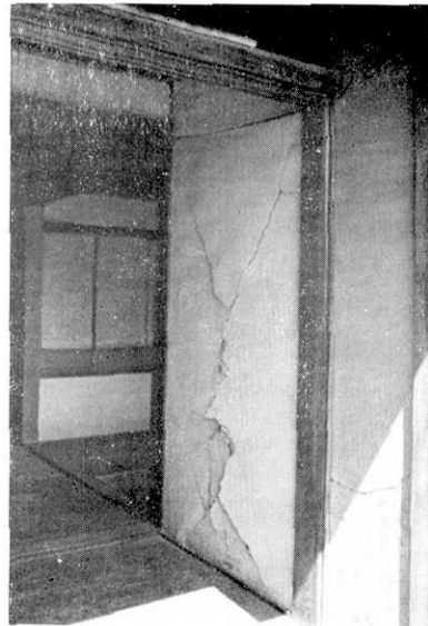
第 16 図 間仕切壁の被害 (中村市小姓町)
