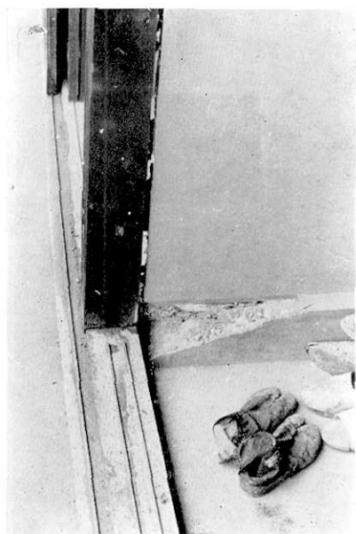
第 19 図 基礎の破損 (宿毛市萩原)
