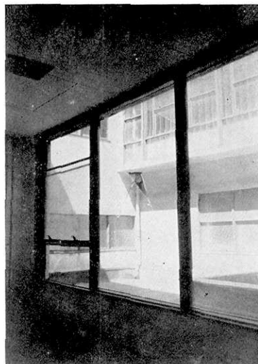
第 26 図 窓ガラスの被害 (大分県庁舎) (村上雅也氏撮影)
