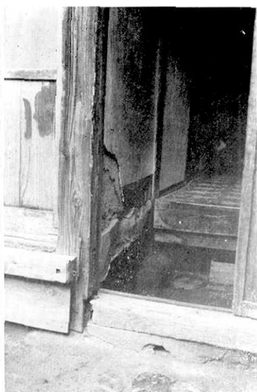
第 21 図 土台の破損と柱の移動 (大月町柏島)
