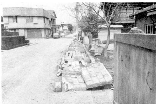
第 22 図 ブロック塀の倒壊 (中村市青木路町) (中村市役所提供)
