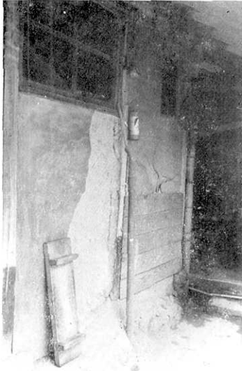
第 15 図 外壁の被害 (佐賀町)
