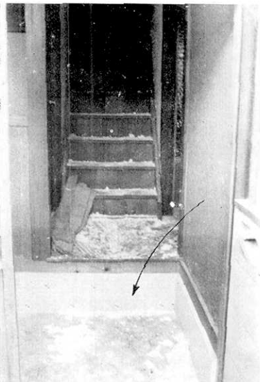
第 17 図 壁の被害 (清水市汐見町)
