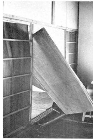
図 13. 松代屋地地区: 板戸のバックリング、(I)の被害。
