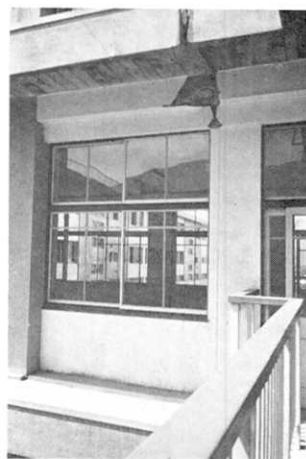
図 31. 戸倉上山田: 同詳細, エクスパンションジョイント部分の被害. (I) と (II) の被害.
