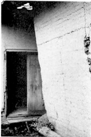
図 22. 松代西寺尾地区：納屋の傾斜。(I)の被害。
