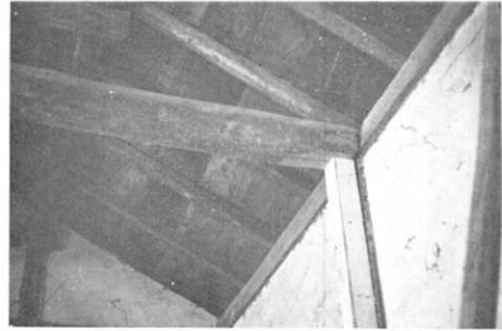
図 18. 松代西条地区：梁の抜け出し（現在補強してある）。（Ⅰ）の被害。
