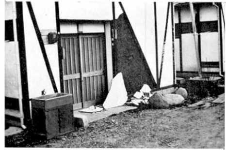
図 6. 長野市長池地区: プラスター壁のはくり. (III)の被害.
