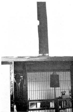
図 23. 松代東寺尾地区：鴨居が下り，ふすまに被害。(I)の被害。
