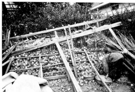
図 27. 更埴市土口地区: たまねぎ小屋の倒壊. (I) の被害.
