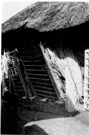
図 5. 須坂米持地区: 同上詳細外壁がはみ出している.
