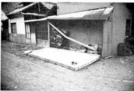
図 17. 松代市街地：ブロック塀の転倒（基礎が弱く控壁も取っていない）。（Ⅱ）の被害。
