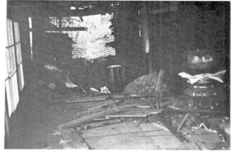
図 12. 若穂春山地区: 岩石の落下による寺社の被害、(IV)の被害。
