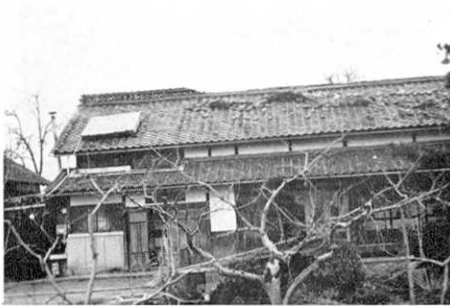
図 10. 長野市長池地区: グシ瓦の落下、(II)の被害。
