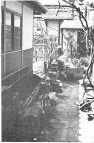
図 15. 松代市街地：ブロック塀の崩壊（鉄筋補強なし）。（Ⅱ）の被害。
