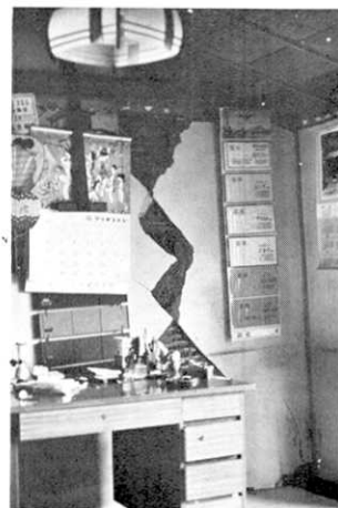
図 26. 松代平林地区：土壁，しつくい仕上のきれつ。(III)の被害。
