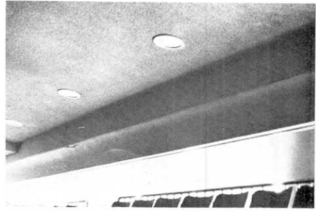
図 35. 須坂市街地：同詳細，鉄筋コンクリート梁とこれに直交する鉄骨梁の接合部分の仕上げのはくり。(Ⅲ)の被害。
