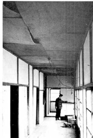
図 14. 松代屋地地区: 天井のバックリング、(I)の被害。
