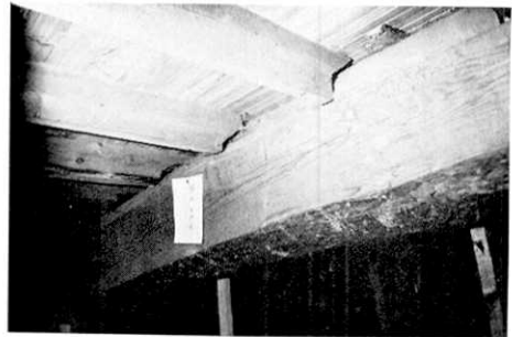
図 19. 松代豊栄地区：豊栄小学校根太の抜け出し。（Ⅰ）の被害。
