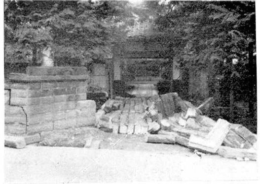
築館町，倒れた石積塀
