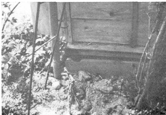
迫町, 町営住宅, 地面の亀裂と沈下
