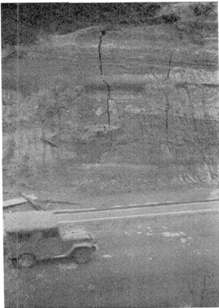
同上, 切割西壁の亀裂
