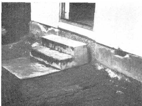
同上，校庭の沈下
