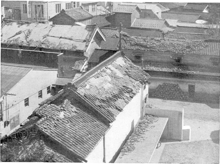
古川市, 屋根瓦の被害
