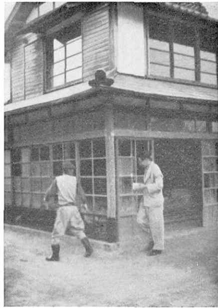
第 3 図 店舗住宅の被害, 1 階の柱が折れている。(田尻町田尻)
