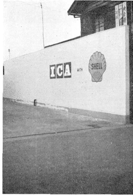
第 7 図 根元に大きれつが入つたコンクリートブロック塀 (田尻町田尻)
