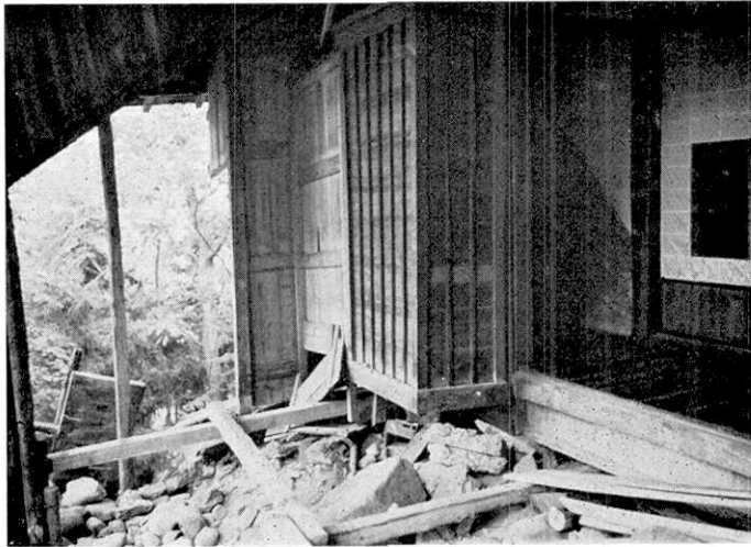
Fig. 7. ガケ崩れで家屋の一部が不同沈下し被害を生じた例. (勝原) (Fig. 6 の家屋に同じ) (森本良平氏撮影)
