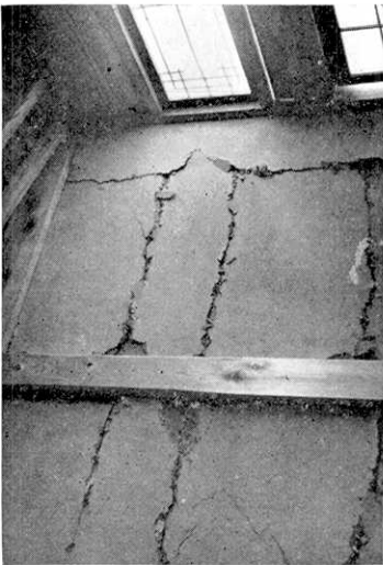
第 18 図 壁の被害状況 (仕上げない壁)
