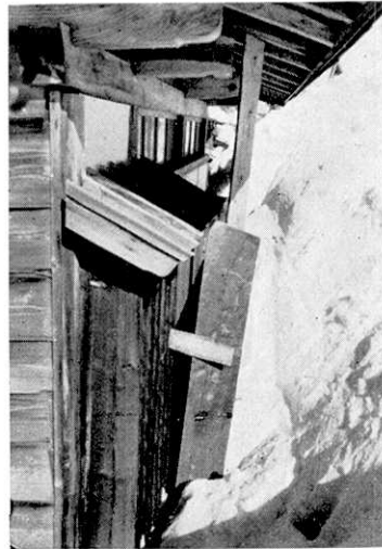
第8図 住宅の側面が積雪でおさえられ、1階の倒壊を防いでいる状況（寺宝町）
