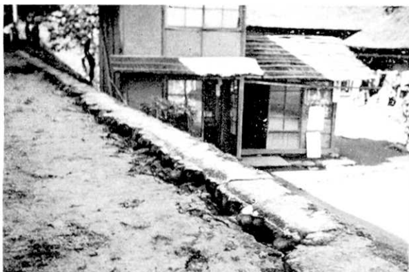
Fig. 12. 白石市内における亀裂
