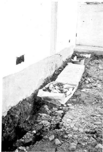
Fig. 14. アパート基礎の破壊
