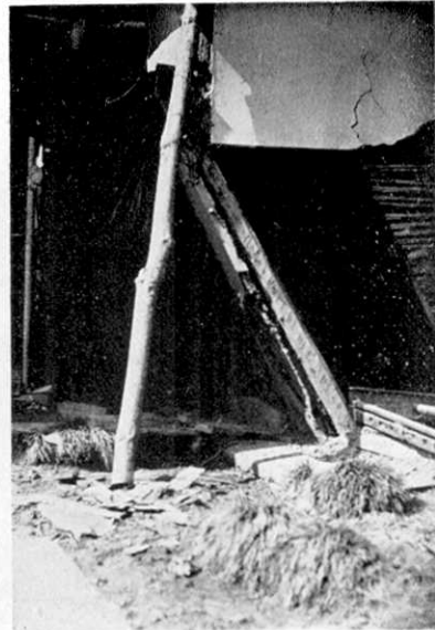
第 19 圖 下部腐蝕の土藏の破損. 南向, 西へ(長沼村穗保)
