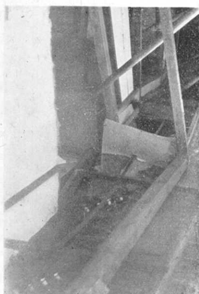
第 13 圖 軒桁中央部で破損。南向，南へ(神郷村南郷)
