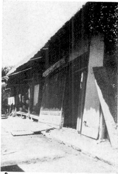
第 14 圖 柔構造住家倒壊. 南向, 北へ (長沼村大町)
