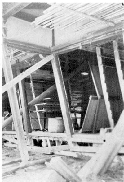
第 6 圖 表柱破損小壁龜裂なし. 南向, 南へ(長沼村穗保)
