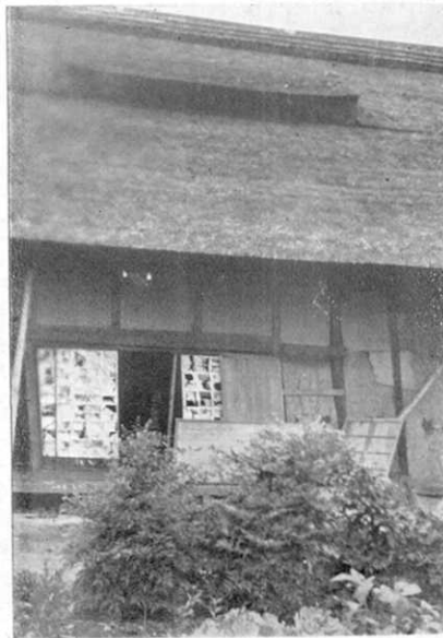
第 16 圖 鴨居より上部損傷なし. 南向, 東(浅川村東條)
