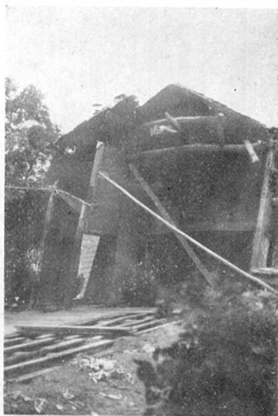
第 11 圖 倉庫，兩側壁部を残し中央部倒壊。南向，南へ(古里村三才)
