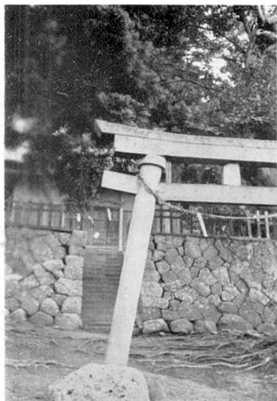
第 31 圖 鳥居横へ傾斜，貫破損（淺川村押田）
