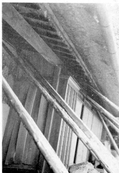
第 12 圖 軒桁中央部で破損。南向，南へ(長沼村赤沼)
