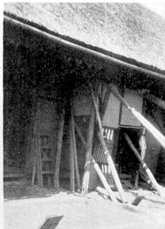
第 7 圖 長沼村農家柱の破損
