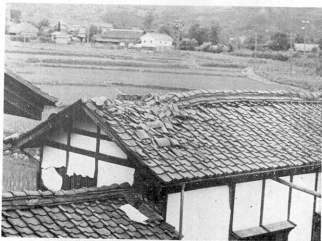
第 18 圖 壊れたる便所の屋根及壁(同上)
