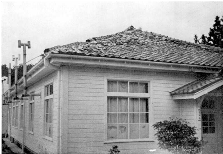
第 7 圖 京都帝大瀬戸臨海研究所實驗室の屋根の破損
