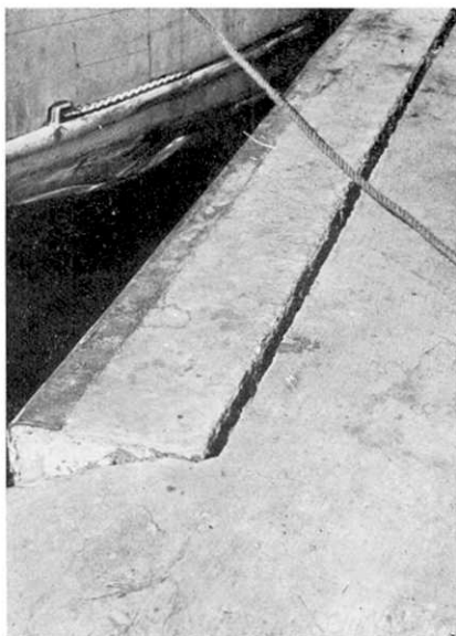
(c) 田邊町岩壁の亀裂
