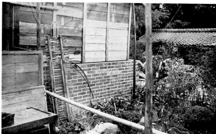
第 16 圖 静岡市高松倉庫滑動
