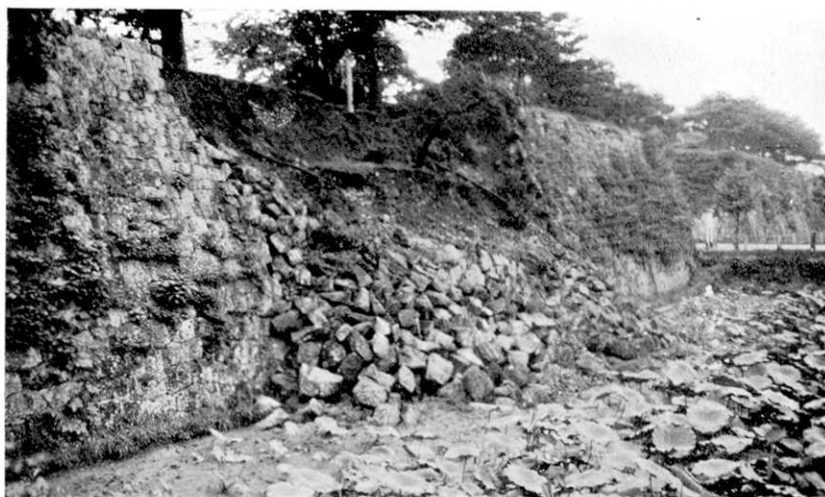
第 23 圖 静岡縣廳石垣の崩壊
