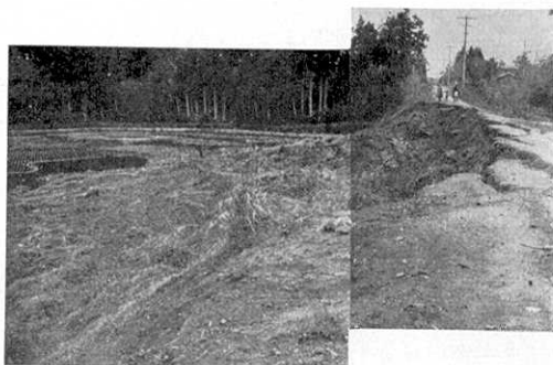
雲出鳥越間縣道の缺壊及龜裂 Fig. 2 d
