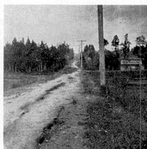
雲出鳥越間縣道の缺壊及龜裂 Fig. 2 c
