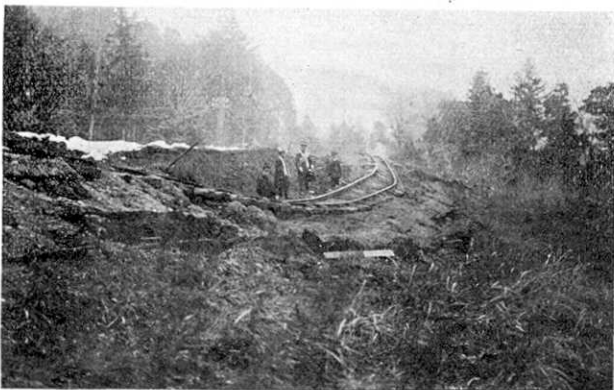
丙. 城山隧道 南方線路の崩壊 (宮津保線課撮影)
