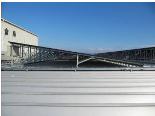
図 2-1-2-2 脚付きの屋根架台
