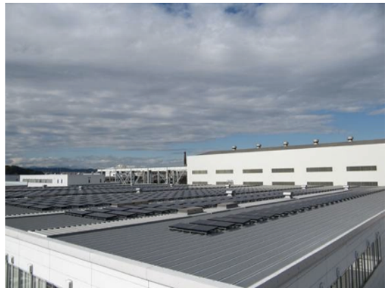
図3-2-1-1 システム全景
