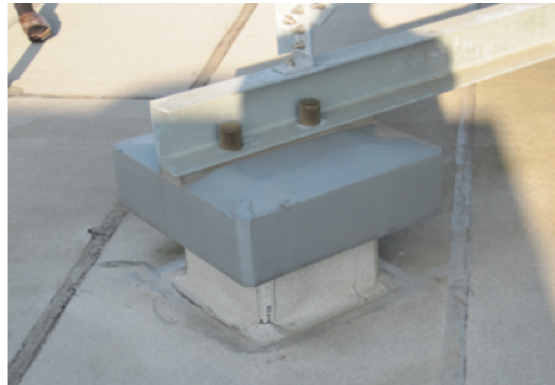
図3-2-2-6 架台と立ち上がり基礎
