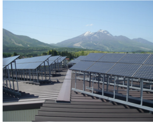
図 3-2-1-6 システム全景
