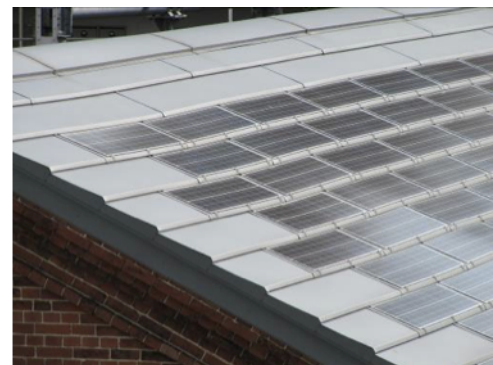
図 3-2-6-6 建材一体 PV の外観
