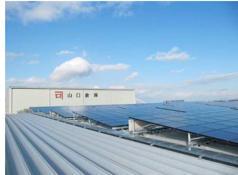
図3-2-1-9 システム全景
