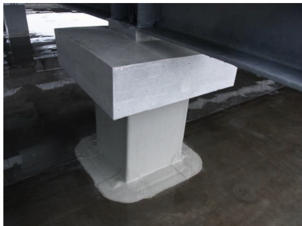
図 3-2-3-6 架台と立ち上がり基礎
