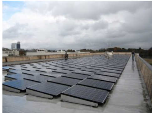
図 3-2-3-8 システム全景
