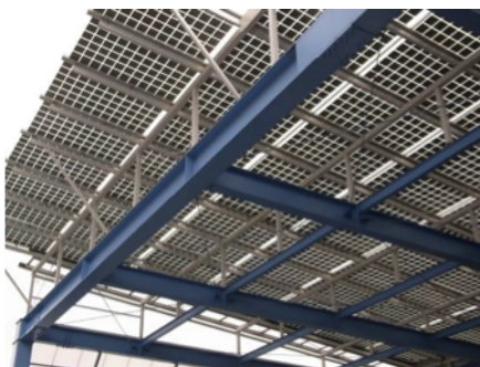
図 3-2-6-8 建材一体型 PV
