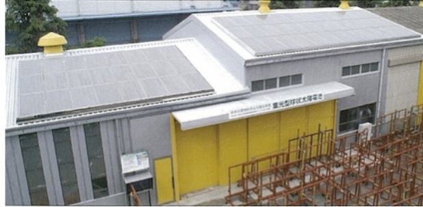
図 4-2-6-1 K 社工場には PV が設置されている
