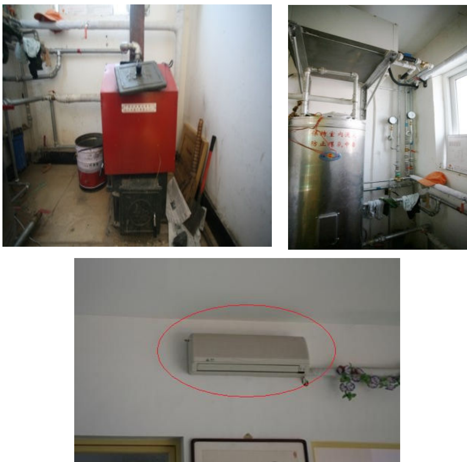
図4-1-30 太陽熱利用システム 左上：補助熱機器 右上：蓄熱槽 下：送風機
