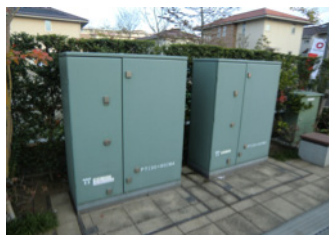
図 4.3.16 路上変圧器とコモンスペース
