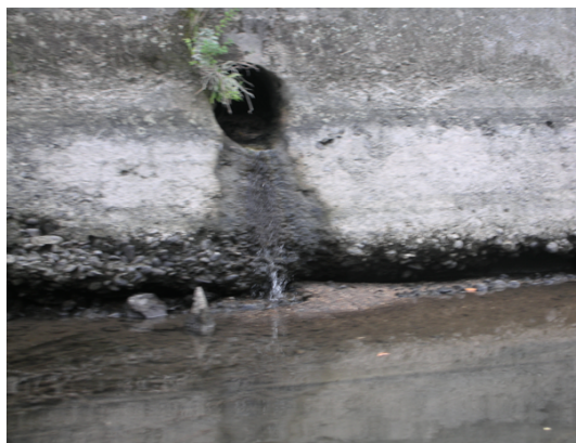
写真-3.9 堀割に流入する廃水
