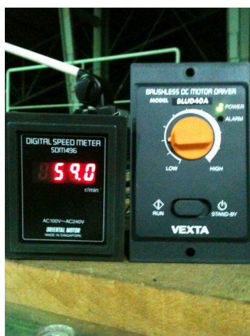
Fig.2.3.2.7 モータードライバーとスピードメーター
