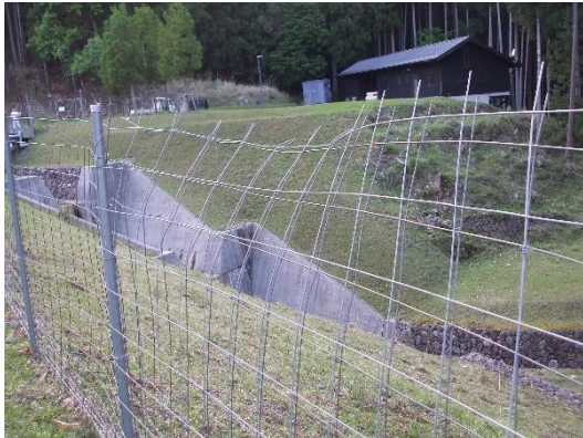
① メッシュ柵がシカの飛び越えで歪んでいる
