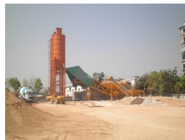
図 27 コンクリートプラント
