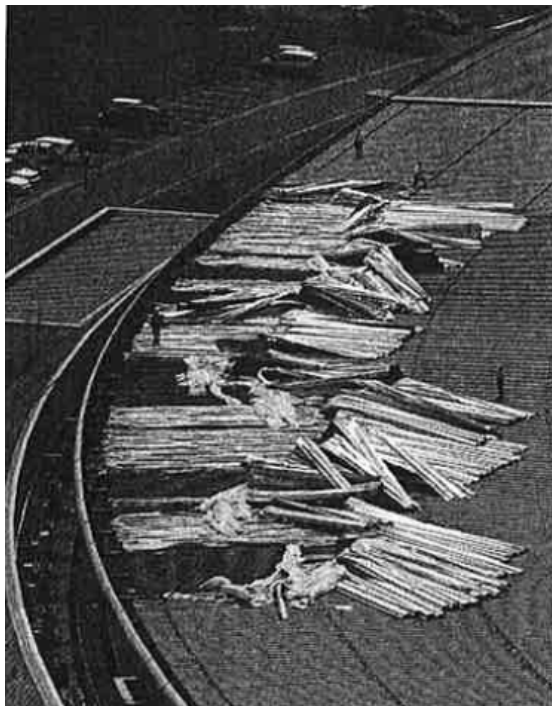
図 1.3.2 2004 年台風 18 号による Spring-8 蓄積リング棟屋根の被害 7)
