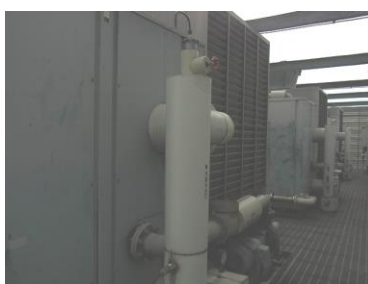
写 3-2 屋上設置のガス焚冷温水機
