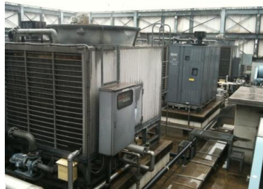
写 3-1 屋上設置のガス焚吸収式冷温水機
