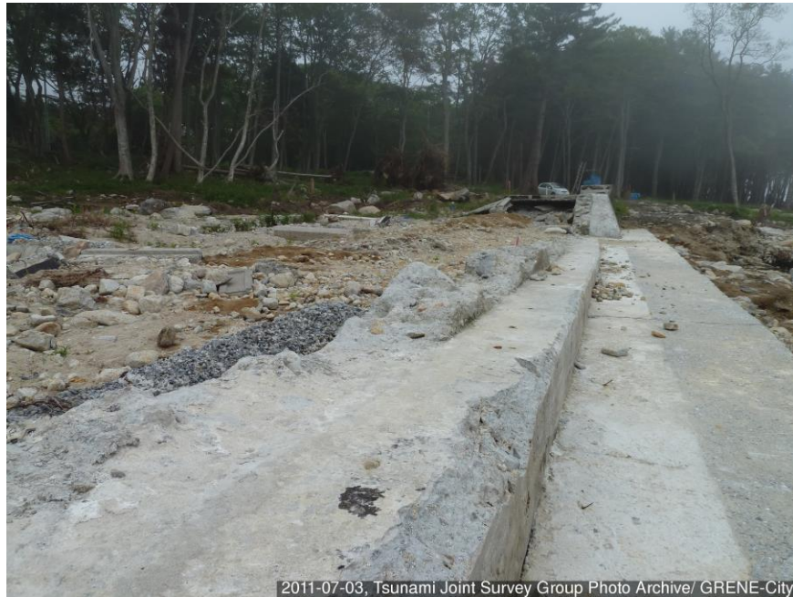
写真 4-3 吉浜湾における被災状況
