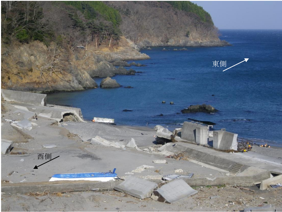
写真 3-5 綾里湾白浜海岸北側の堤防破壊状況(2011 年 4 月撮影)
