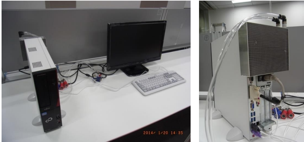
図 4.7 熱回収装置の設置様子
