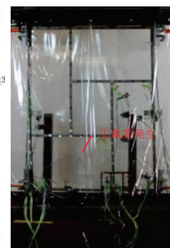
図18 損傷状況写真
