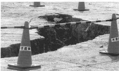
図12 グラウンドの陥没
