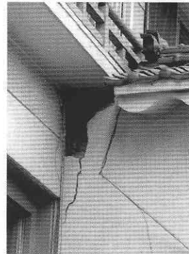
図13 屋根瓦の落下(上)と壁面の亀裂(下)
