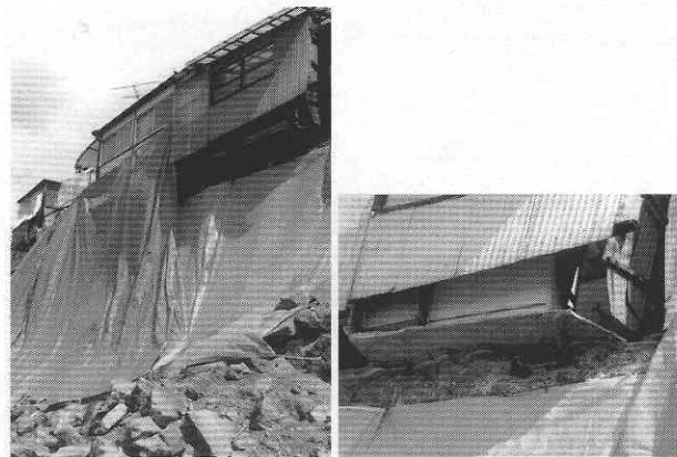
図10 石垣の崩壊(左)と上部の家屋(右)
