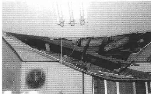
図7 屋根が損傷した家屋の天井
