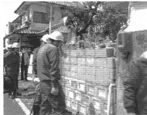
図9 ブロック塀を診断する消防士
