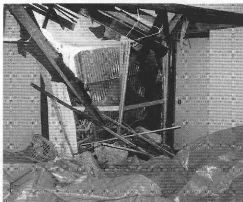
図8 屋根が損傷した家屋の居間
